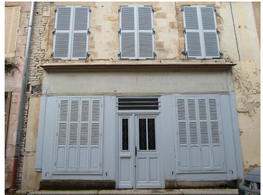
La même teinte, gris-bleu, pour la devanture commerciale et les volets met la façade en valeur
